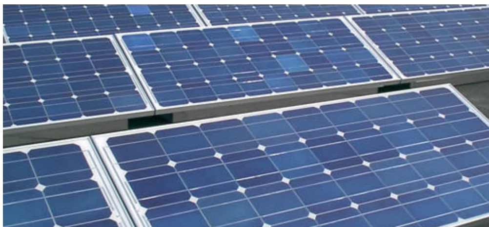
Imatge 30. Fotografia d'uns panells fotovoltaïcs.
