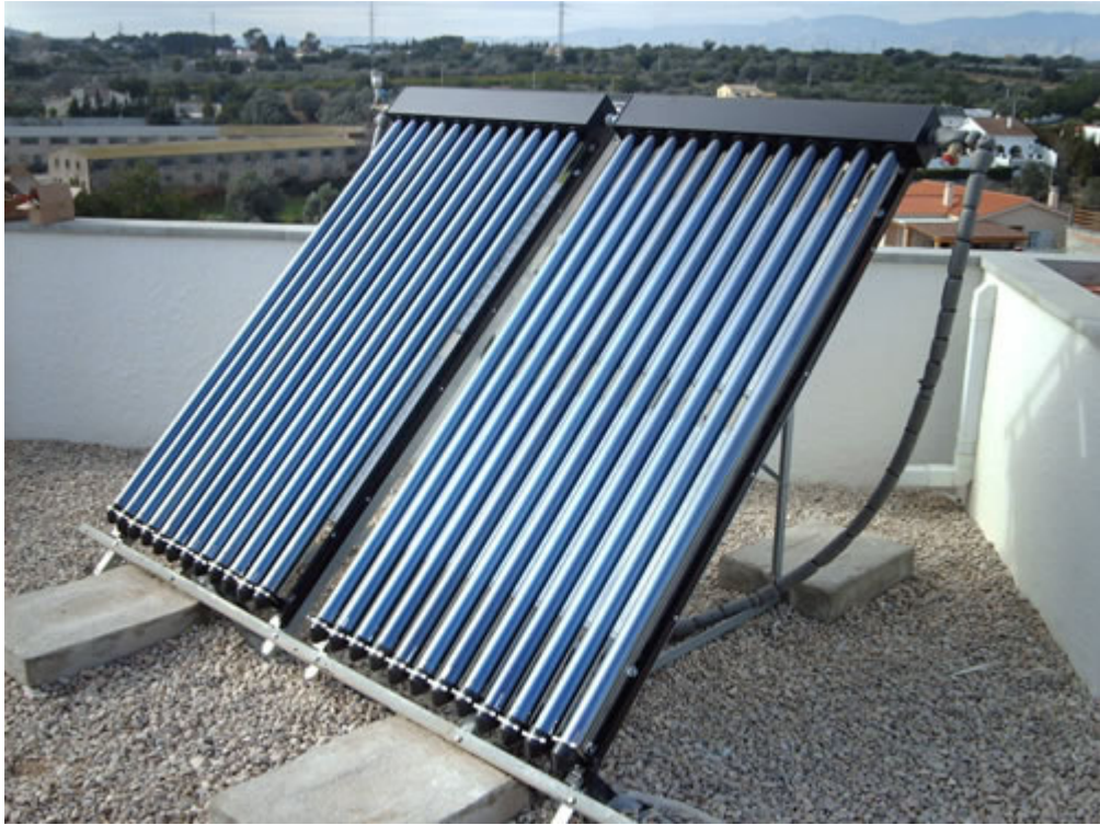
Imatge 17. Fotografia d'un captador solar de tubs de buit.
