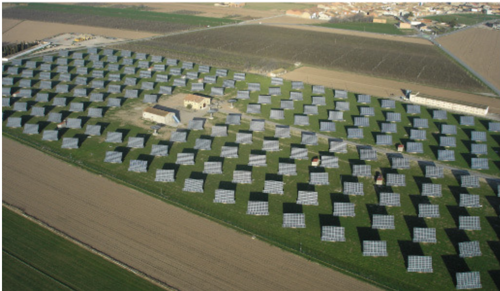
Imatge 34. Parc solar fotovoltaic a El Poal (Lleida). Aquest parc solar fotovoltaic és un dels més grans de Catalunya i té una potència de 2.000 kW.
