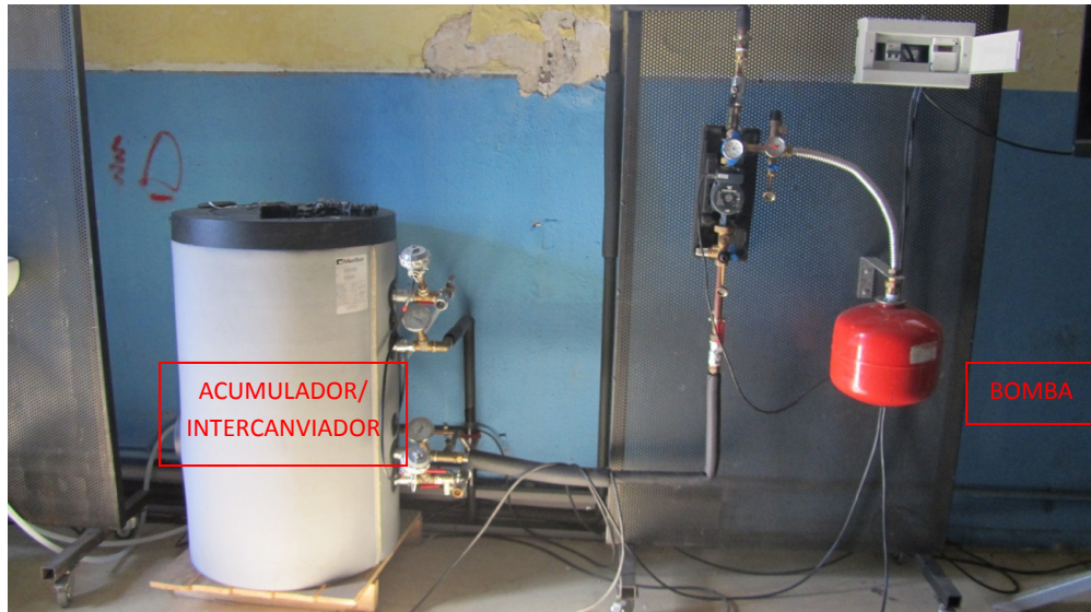
Imatge 58. Fotografia de l'acumulador intercanviador i la bomba.
