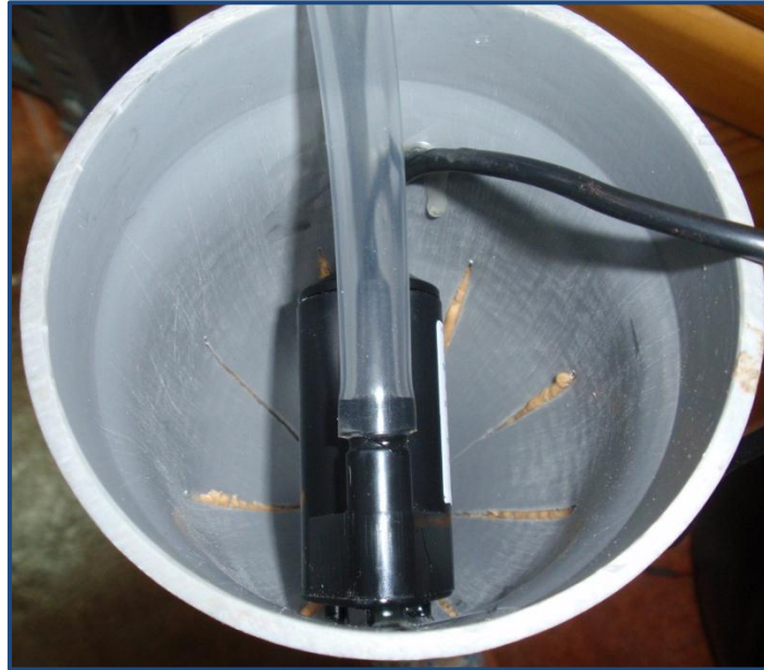
Imatge 63: bomba que absorbirà l'aigua dels dipòsits i l'expulsarà a fora
