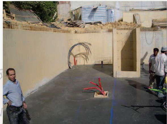
Font: La casa sostenible. http://www.lacasasostenible.com/climatizacion-geotermica.html
