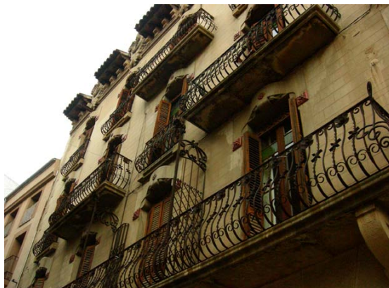
Fotografia que reflecteix el desnivell dels balcons
